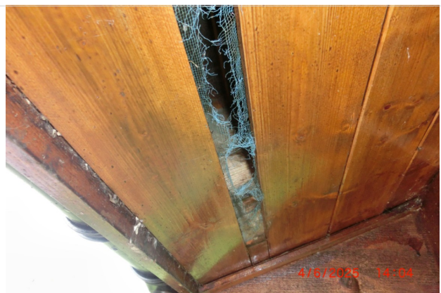
Myggetetting i lufespalte i tak konstruksjonen er slitt.
