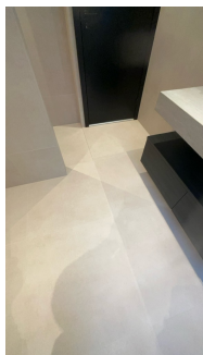
Flis med hulllyd under ved overgang mot dusjsone.
