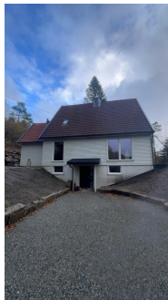
Ikke montert snøfangere på takflate.
