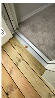
Lite høydeforskjell mellom terrassedekke og terskel
