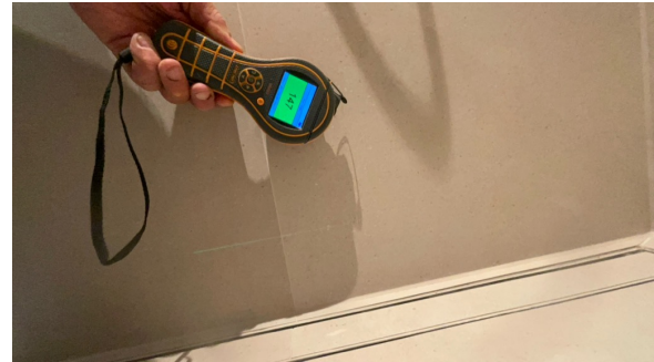
Overflatesøk på vegg i dusjsone.
