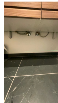
Hull i veggplate rundt avløpsrør fra servant er ikke vanntett. Ligger i våtsone
