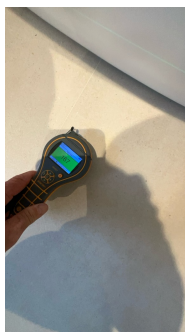
Overflatesøk på gulv ved badekar.
