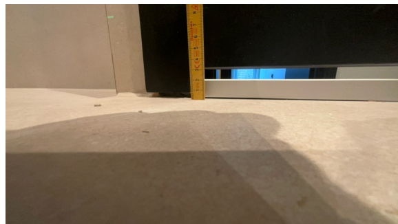
Oppkant ved dør ikke synlig - tildekket av beslag
