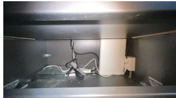
Vifte under benkeplate på kjøkkenøy
