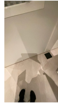
Avløp fra vannskap til gulvflate ved sluk i bodrom.
