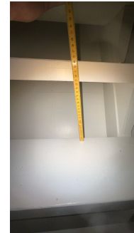
Avstand mellom trappetrinn over 10 cm.
