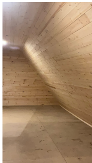
Del av innvendig skråtak som har mindre ujevnheter nedbøyning.
