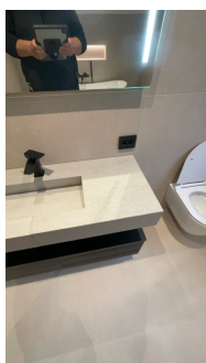
Elektrisk kontakt i vegg i våtsone ved vask
