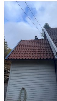
Ikke montert snøfangere på takflate.
