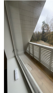
punktert glassrute i soveromsvinduet.
