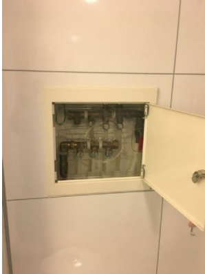
Rør i rør skap.
