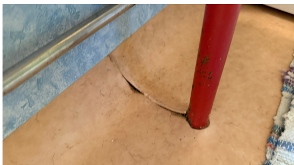
Eksempel på utett rørgjennomføring
