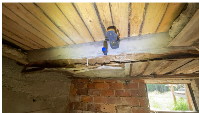
Råte og høyt fukttinnhold i stubbloft/etasjeskiller mot kjeller
