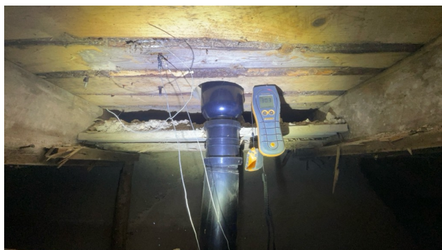
Fuktig ved sluk fra krypkjeller, men dette kan også skyldes det fuktige kjellermiljøet
