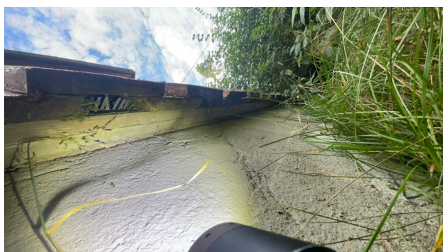
Ikke utlektet/uluftet panel
