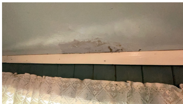
Ved trapperom synlig eldre fuktskader i overgang vegg/tak (ikke målt unormal fukt befaringdagen)
