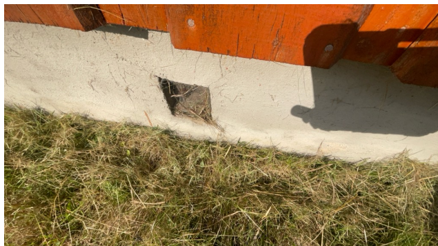
Ikke tilkomst under kjøkken (ventiler påvist)
