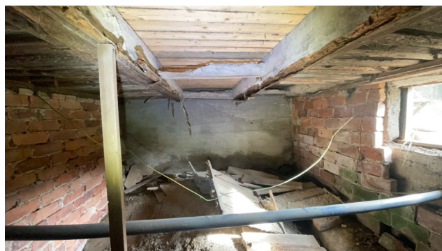
Råteskadet stubbloft som er falt ned
