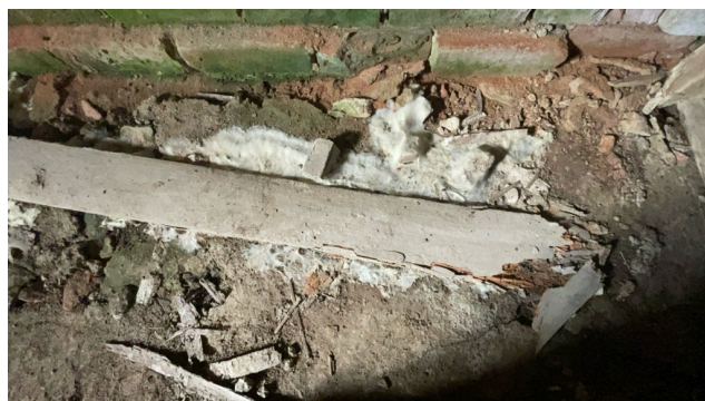
Råteskadet treverk m/sopp på grunn (ikke fuktsperre over grunn)
