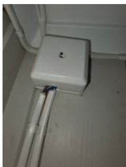
Ledning avmantlet utenfor koblingsboksen
