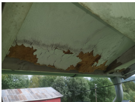
Undertak på inngangsparti.
