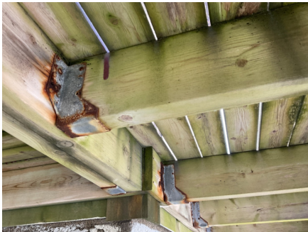
Korrosjon på bjelkesko
