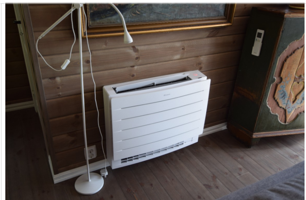
Varmepumpe luft / luft
