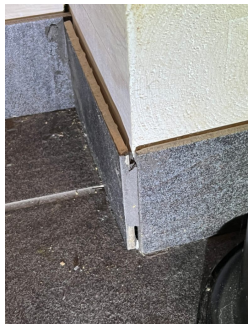
Sokkelfliser. Manglende fug/silikon.
