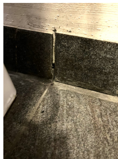
Ingen membran/oppkant bak sokkelfliser langs vegger
