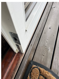
Terrassedør. Utett treverk-list/løsning.
