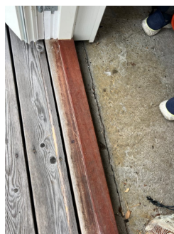
Boddør. Utett treverk-list/løsning.
