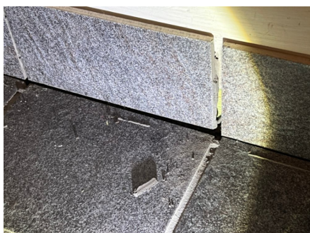
Ingen membran/oppkant bak sokkelfiser langs vegger
