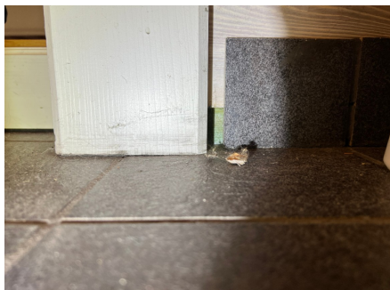
Ingen membran/oppkant bak sokkelfiser langs vegger
