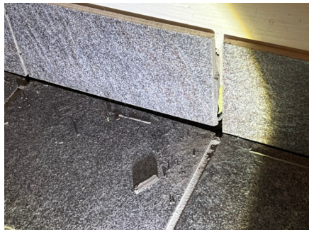
Sokkelfliser. Manglende fug/silikon.
