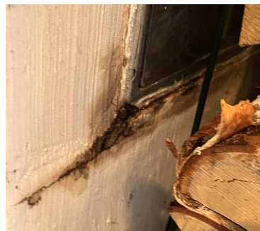
Fukt/Sotrenning ved feieluke.
