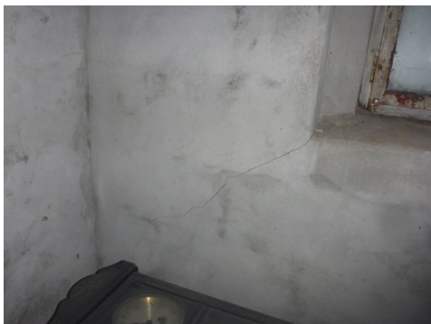
Viser skråriss som er symptom på setninger.
