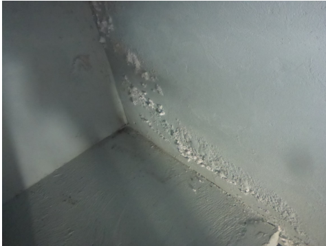
Viser saltutslag som er en indikasjon på fuktgjennomtrengning
