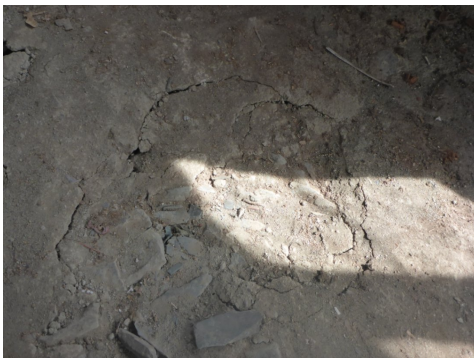
Viser kjellergulv som krakelerer i kjellerrom sørøst
