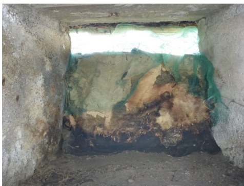
Viser åpning og spor etter mus i kjellerom sørvestlig hjørne.
