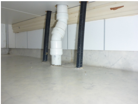
Viser utette løsninger oppstikk under servanttinnredning.
