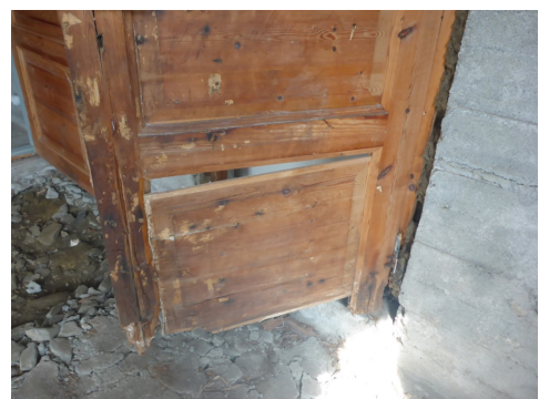
Innerdør i kjeller med råteskader.
