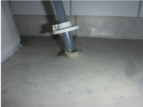
Viser utett løsning oppstikk vannledning klosett
