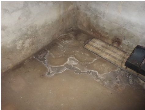
Viser saltutslag/fuktskjolder gulv på grunn som er en indikasjon på fuktgjennomtrengning
