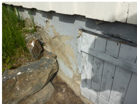
Viser avskalling av puss.
