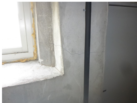
Viser horisontalriss som er symptom på jordpress.
