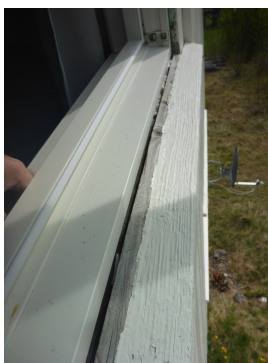
Viser uheldig løsning med vannbrett under vindu.
