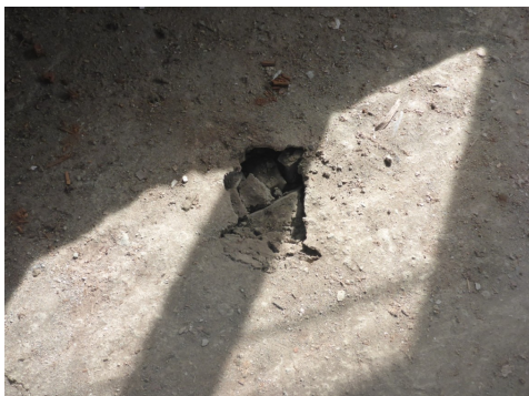
Viser kjellergulv som krakelerer i kjellerrom sørøst.
