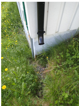
Viser takrennenedløp mot nordvest som ikke ledes vekk fra grunnmuren.
