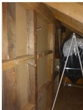
Viser deler av yttervegger på kneloft uten veggisolasjon.
