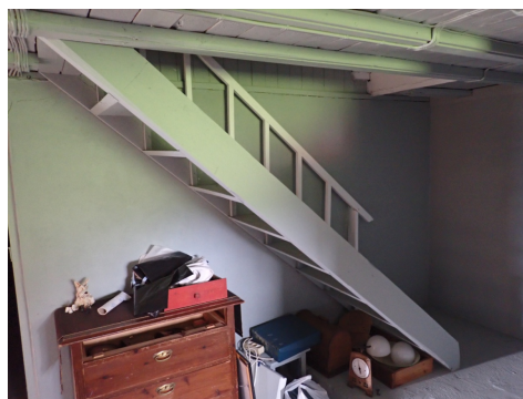
Viser kjellertrapp uten rekkverk.
