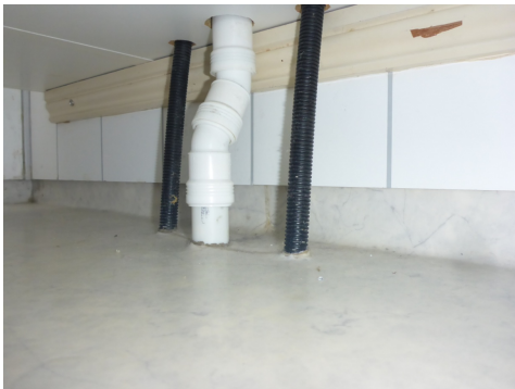
Viser utette løsninger oppstikk under servanttinnredning.
