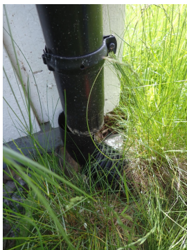
Viser takrennenedløp mot sørvest som delvis går utenom drensledning.
