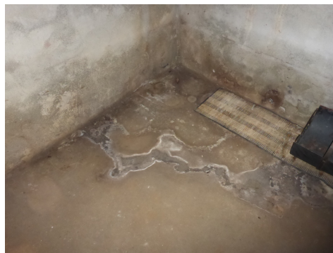
Viser saltutslag/fuktskjolder gulv på grunn som er en indikasjon på fuktgjennomtrengning.
