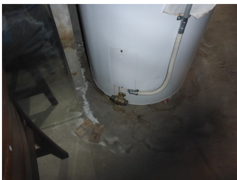
Viser bereder preget av rust.
