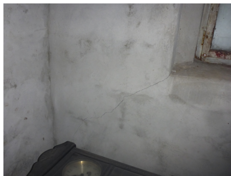
Viser skråriss/sprekk i kjeller.
