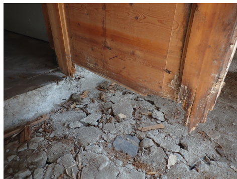
Viser innerdør i kjeller med råteskader.
