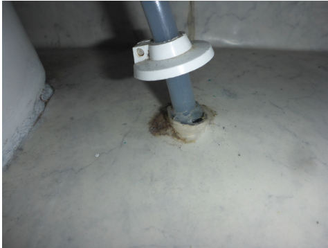
Viser utett løsning oppstikk vannledning klosett.
