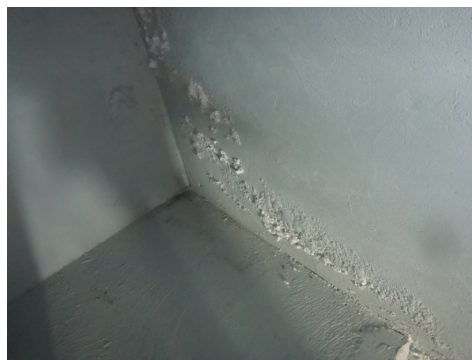
Viser saltutslag som er en indikasjon på fuktgjennomtrengning/kapilærsug.
