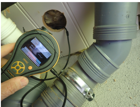
Viser utført fuktmåling fra undersiden av badet uten å avdekke unormale verdier av fukt.
