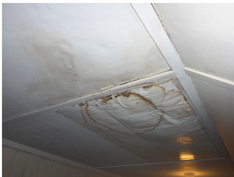
Viser himling i stue 2. etasje med fuktskjolder.
