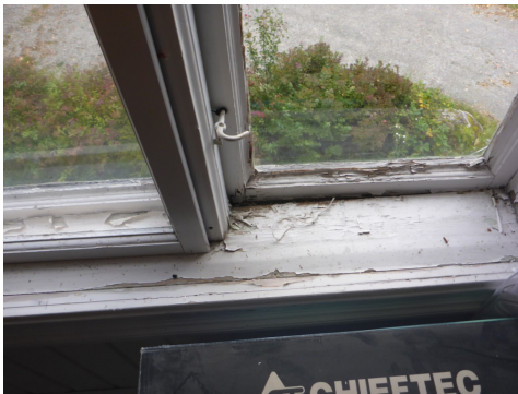
Viser vindu innvendig med slitasje.
