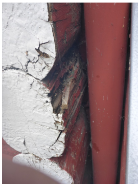
Viser råteskade i lafteknute langvegg mot øst
