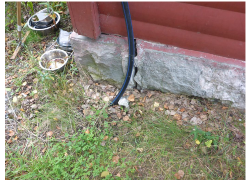
Viser sprekke i grunnmur hjørne mot nordøst
