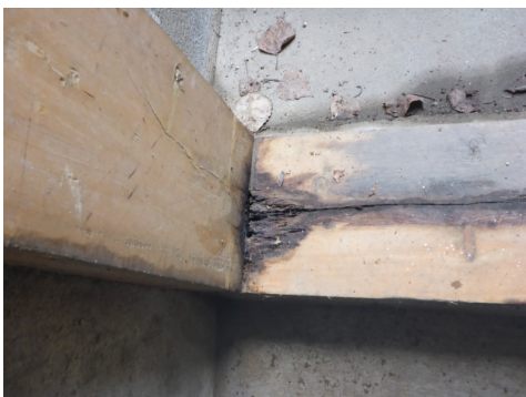
Viser råteskadet terskel kjellerdør.
