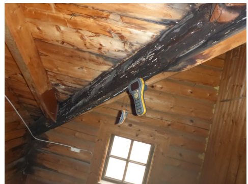
Viser gradsperr med alvorlige fuktskader og svekket bæreevne i bod mot nordøst.
