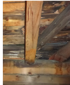
Viser gradsperr og undertak med alvorlige fuktskader i bod mot sørøst.
