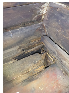
Viser skade på gulv, bjelkelag og yttervegg.
