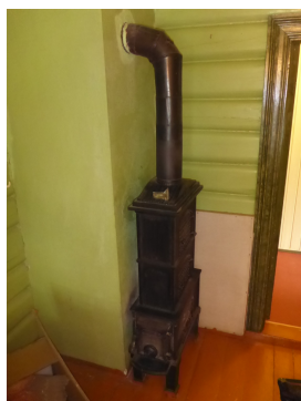
Viser etasjeovn i 2. etasje uten ubrennbar plate på gulv og avstand < 10 cm til pipe.
