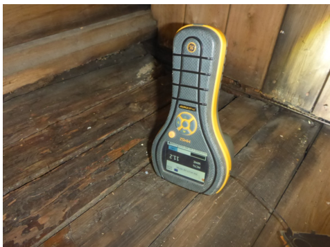
Viser gulv i bod 2. etasje med fukt- og råteskader.
