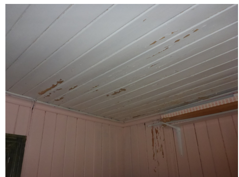
Viser overflater vegger og himling i 2. etasje preget av amlingsflass.
