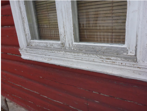
Viser vindu med utvendig høy værsplitasje.
