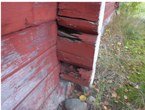
Viser råteskade i lafteknute langvegg mot vest.
