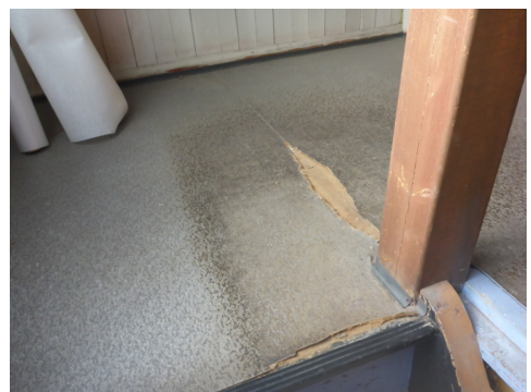
Viser overflate gulvbelegg i 2. etasje preget av høy slitasje.
