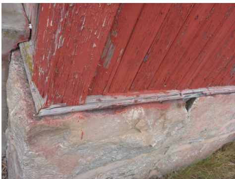
Viser kledning og vannbrett med værslitasje mot sør.
