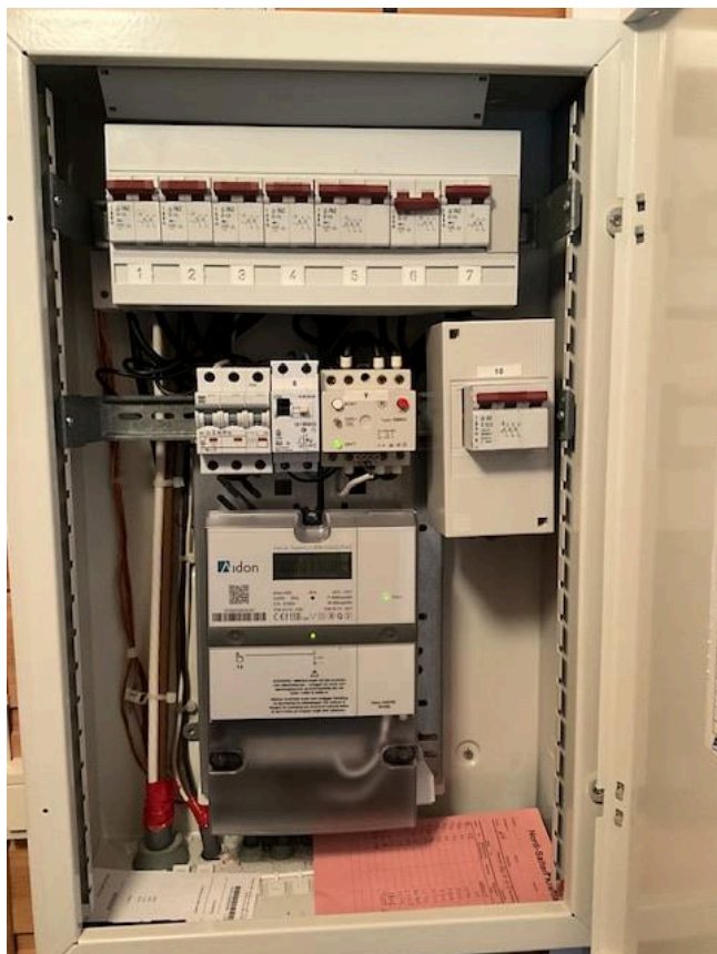
Eldre sikringskap med 10 STK automatsikringer.
