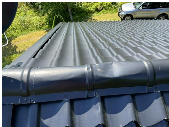
Noen bulker og lakkskader.
