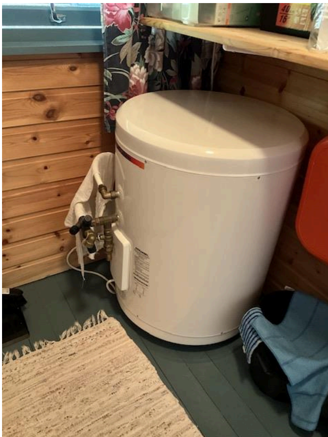
Varmtvannsbereder 115 liter fra 1992.
