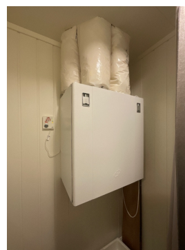
Ventilasjonsaggregatet i boden.
