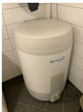
Varmtvannsberederen i boden.
