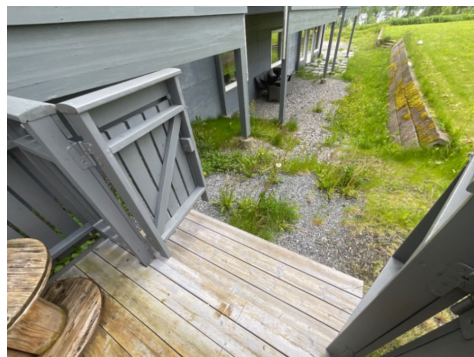
Ett høyt trinn fra balkongen til terrenget.
