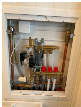
Rørskapet for vannbåren varme.
