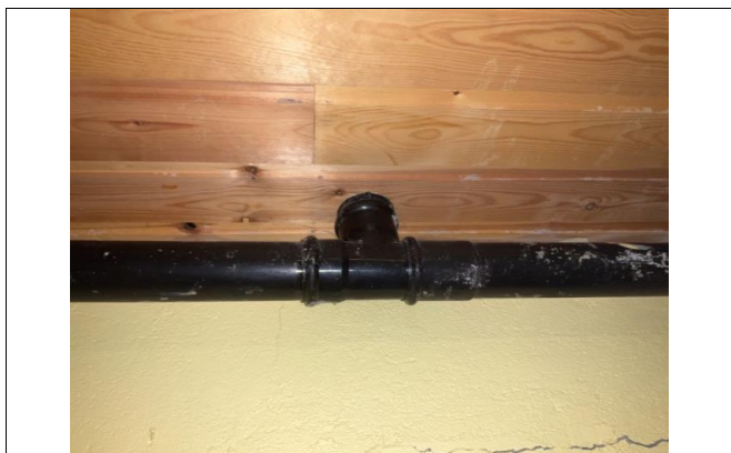
undersøkelse opp mot vaskerom gjennom gjennomføringer av rør
