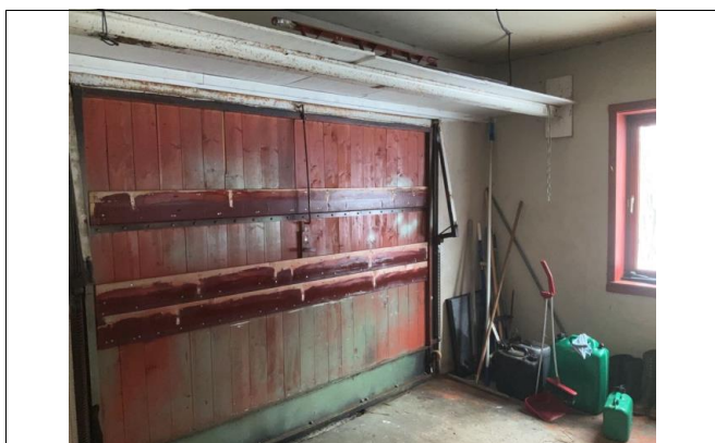
garasjeport til integrert garasje i dårlig stand
