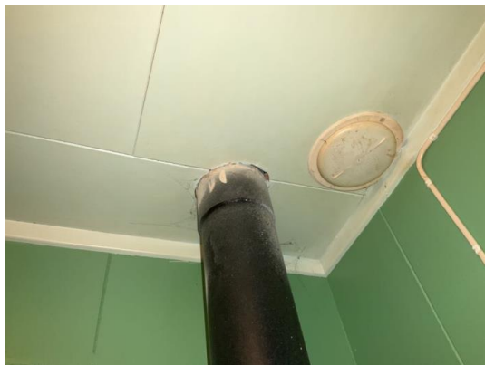
ventil i tak i dusjrom
