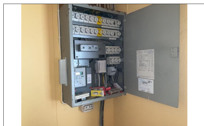
stort eldre sikringsskap i verksted i sokkel
