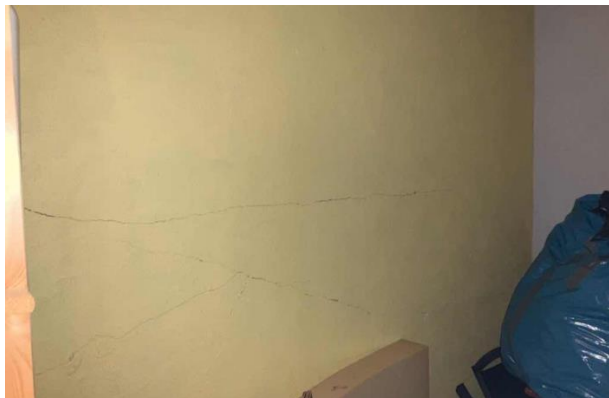
sprekker i grunnmuren
