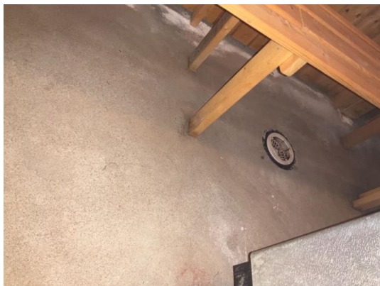
mangler tettesjikt i badstue
