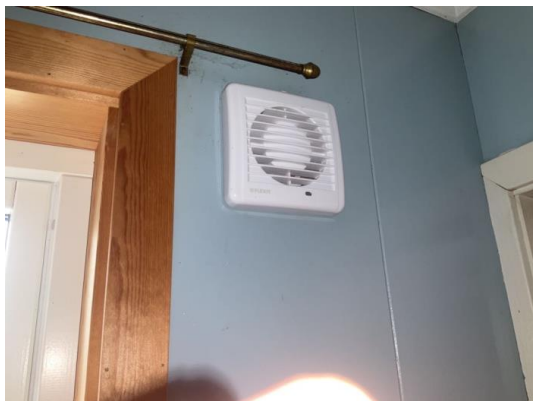
elektrisk vifte på vegg
