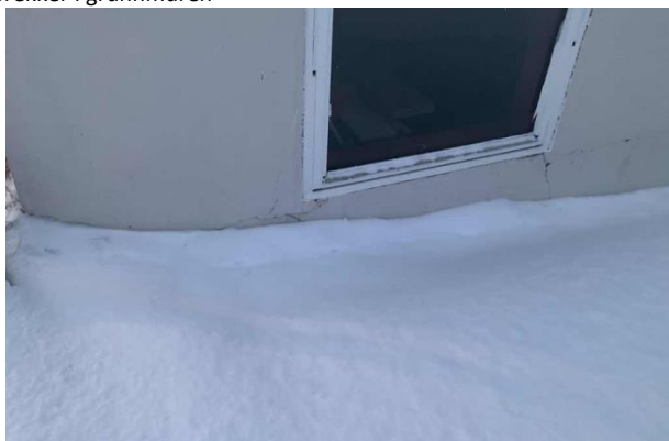
horisontale sprekker i grunnmur
