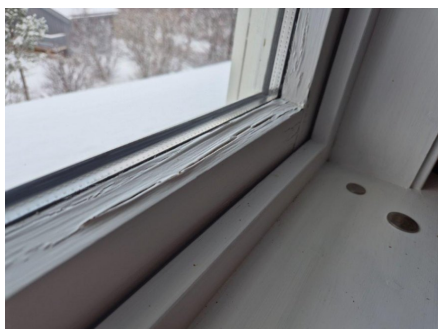
Oppsprekking av maling i vinduskarm.
