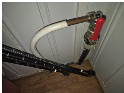
Innvendig stoppekran i bod i underetasjen.
