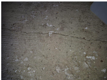
Sprekkdannelse i betonggulv i garasje.
