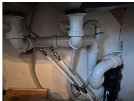
Rørøpplegg i kjøkkenbenk.
