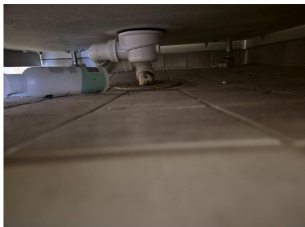
Sluk under dusjkabinett.
