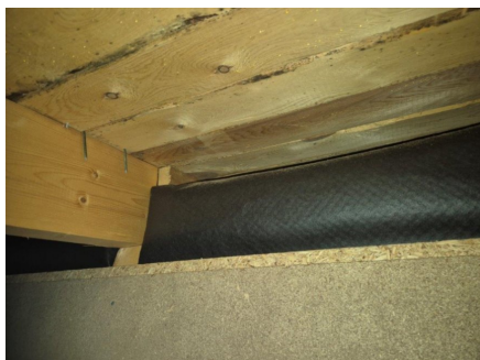
Luftespalte i isolert skråtak/himling.
