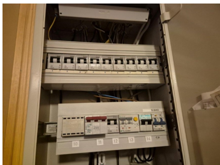
Sikringsskap med automatsikringer.
