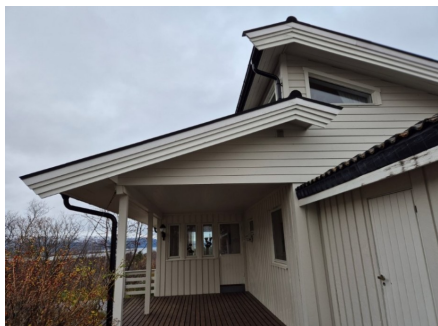
Ventil i gavlvegg over takoverbygg og del av stue.
