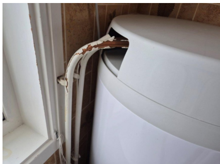
Innvendige vannledninger av kobber.
