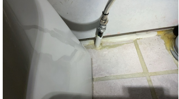
Utettheter i membran rundt rørgjennomføringer.
