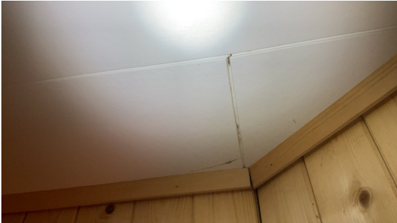
Mindre kondensmerke i himling.
