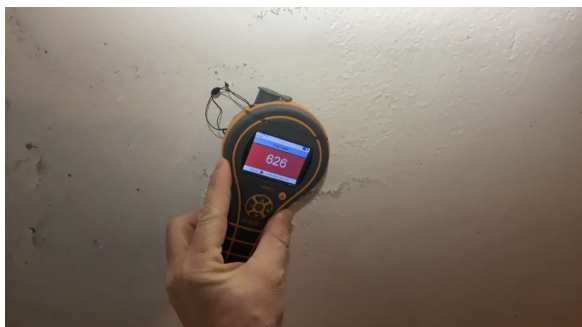
Ved enkle fuktsøk på vegg, ble det registrert områder med forhøyde verdier.
