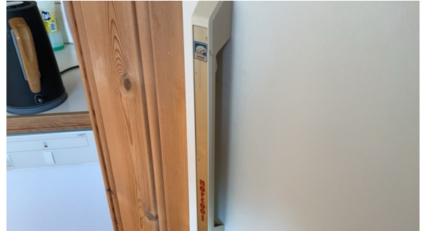
Skade på håndtak til dør.
