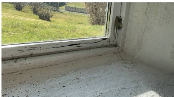
Noe kondensmerker på kjellervindu.
