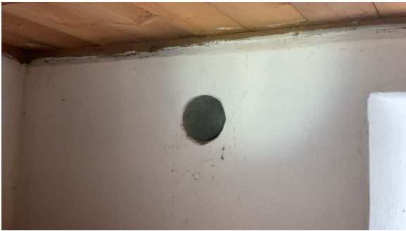
Grunnmuren har sprekkdannelser.
