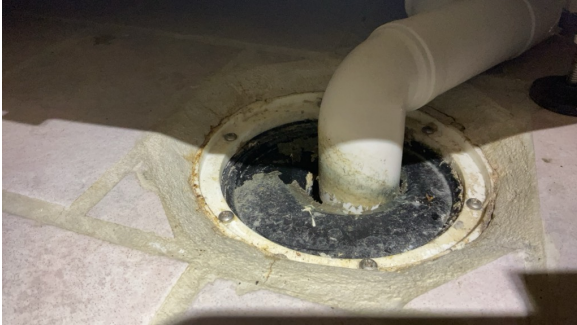
Ikke synlig bruk av membran eller slukmansjett.
