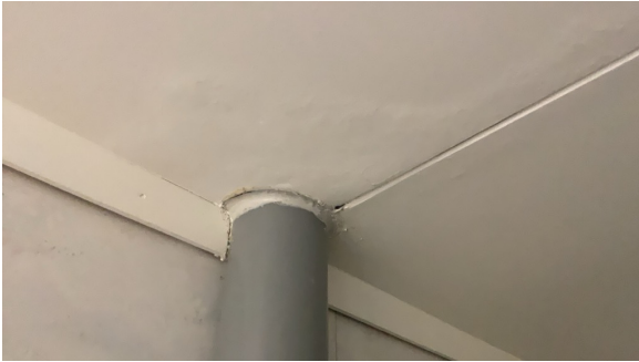
Fuktmerker i himling rundt rørføring.
