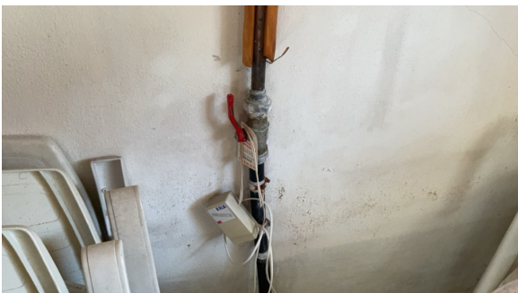
Stoppekran plassert i kjeller.
