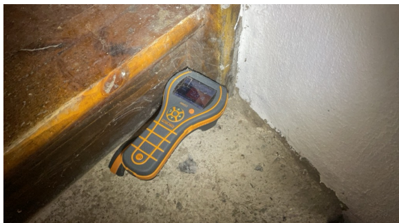
Fuktopptrekk i kjellertrapp registrert.
