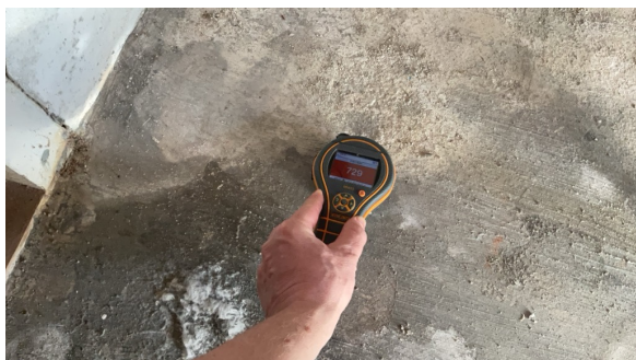
Ved enkle fuktsøk på gulv, ble det registrert områder med forhøyde verdier.
