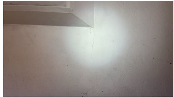
Grunnmuren har sprekkdannelser.
