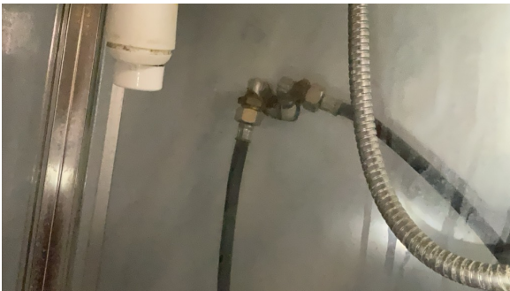
Utettheter i membran rundt rørgjennomføringer.
