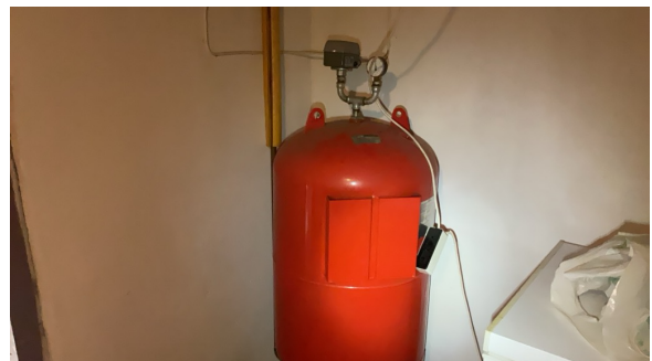
Trykktank plassert i kjeller.
