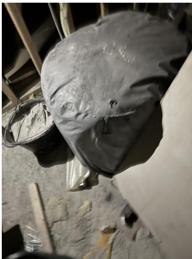
Varmt vanns berede plassert i kjelleren under i presenning.
