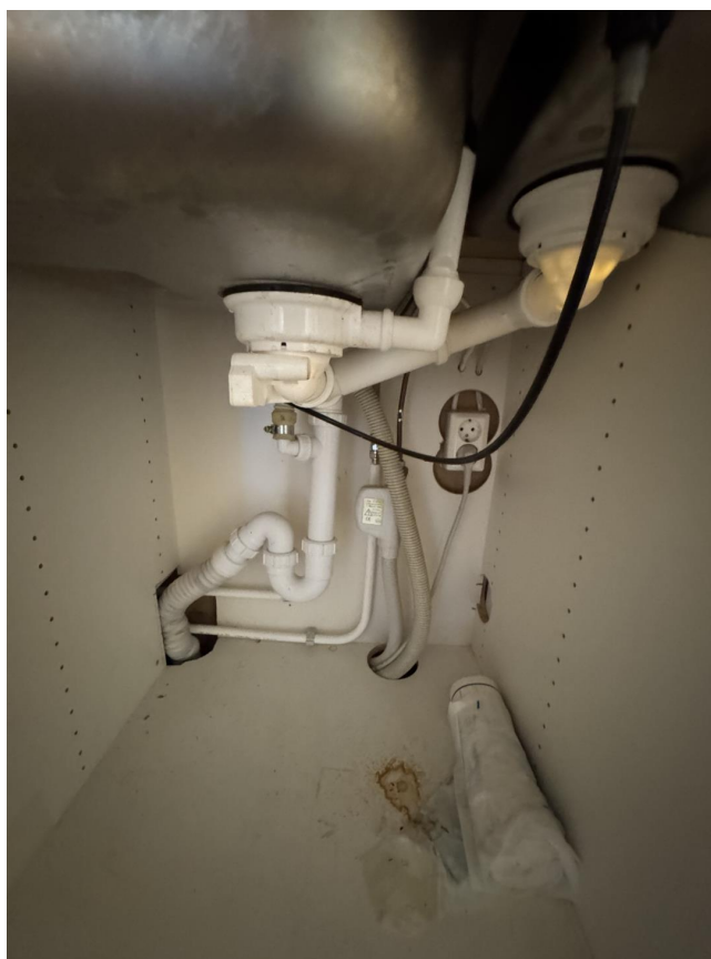
Synlige vann - og avløpsrør i oppvaskbenken.
