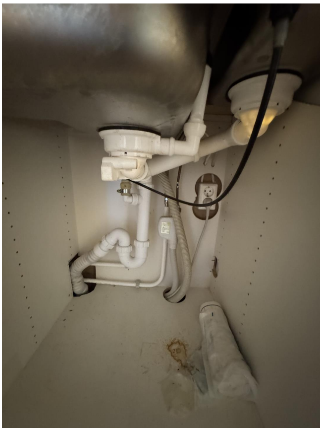
Synlige vann - og avløpsrør i oppvaskbenken.
