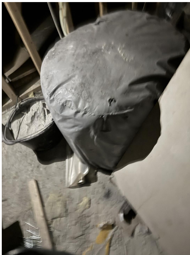
Varmt vanns bereder plassert i kjeller under ei presenning.
