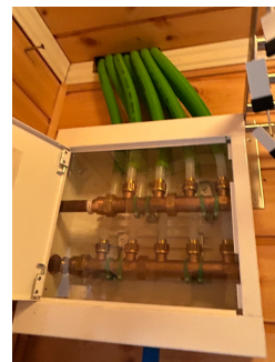
Skap for overrisslingsanlegg er også plassert på boden.
