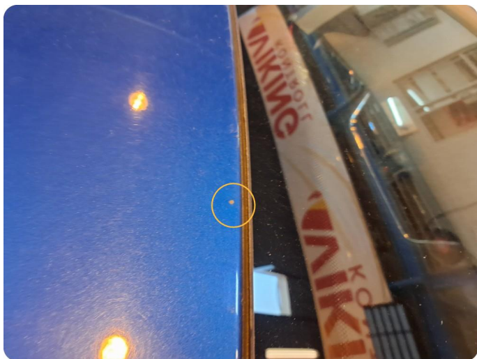
2.6 Generelt mye rust
