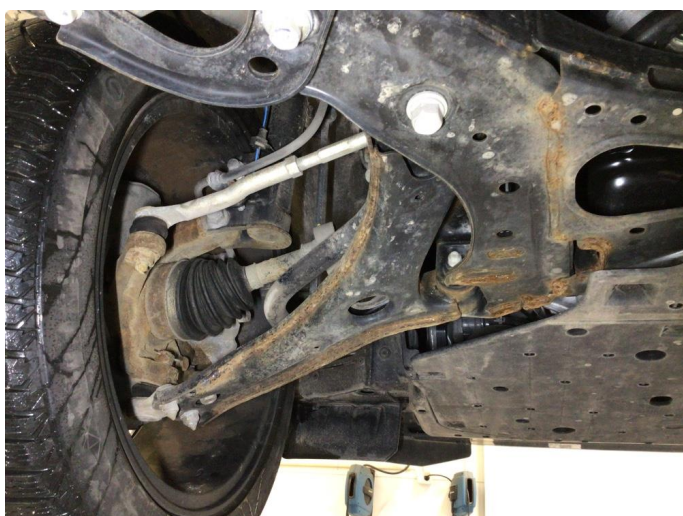
2.1 Overflaterust i forstilling, ingen tiltak kreves
