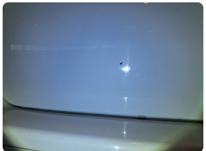
3.1 Generelt mye stensprut Og hakk/små riper
