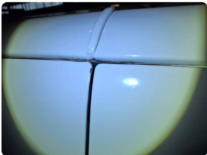
3.1 Generelt mye stensprut Og hakk/små riper
