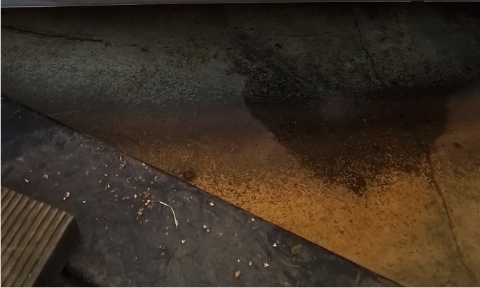
2.1 Div rust, bulker og skader
