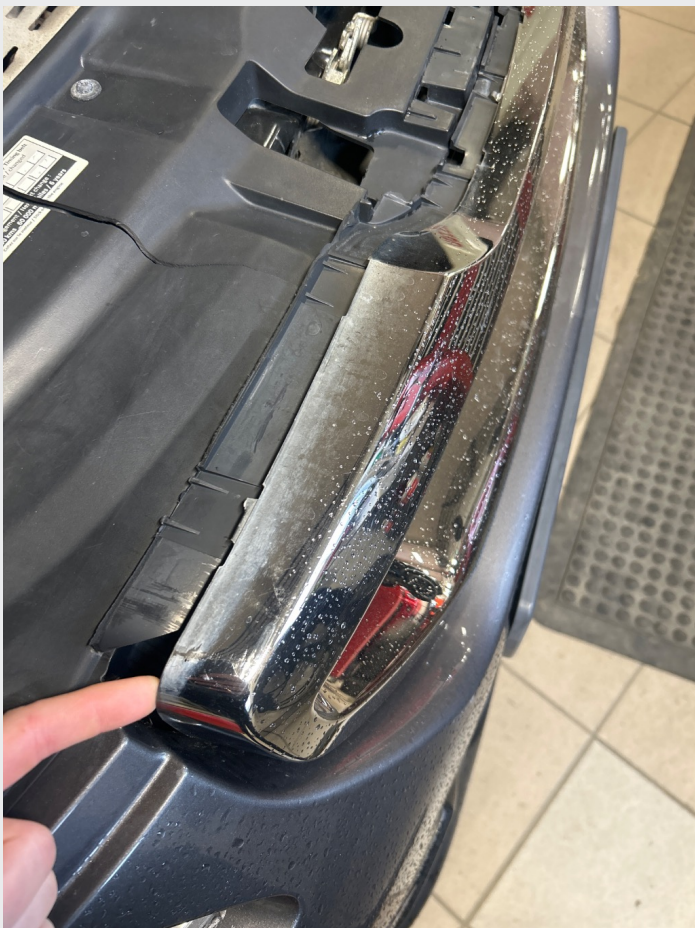
2.8 Grill i framfanger er løs på høyre side, ser ut som det er knekt flere plasser
