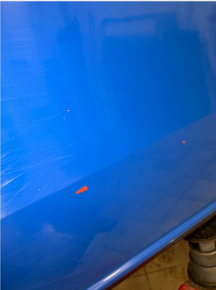
2.1 Noe bulker og småskader
