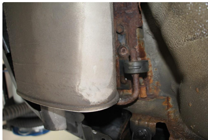
2.2 En hel del rust i chassis, ser også en del rust i dempertårn foran. Kjente ett mykt punkt i rammevange høyre bak.
