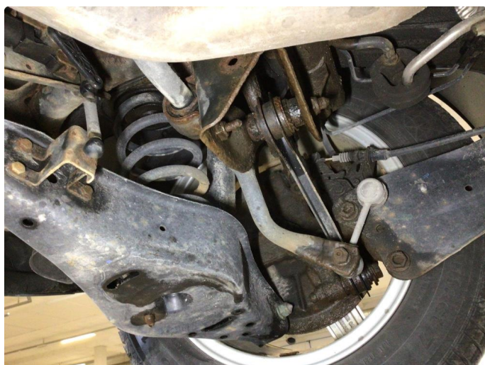
3.2 Overflaterust i bakstilling, ingen tiltak kreves
