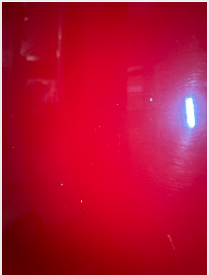
2.1 En del steinsprut og riper rundt om
