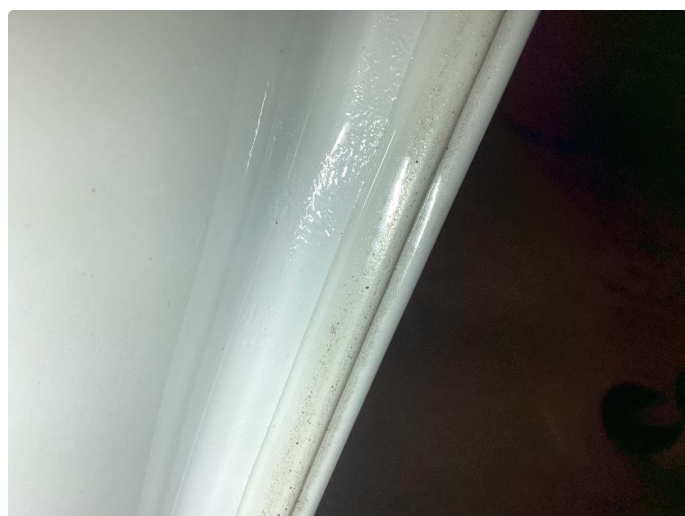
1.1 Rust i fals
