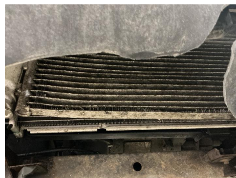
R 42. Varmeapparat / klimaanlegg (AC).
