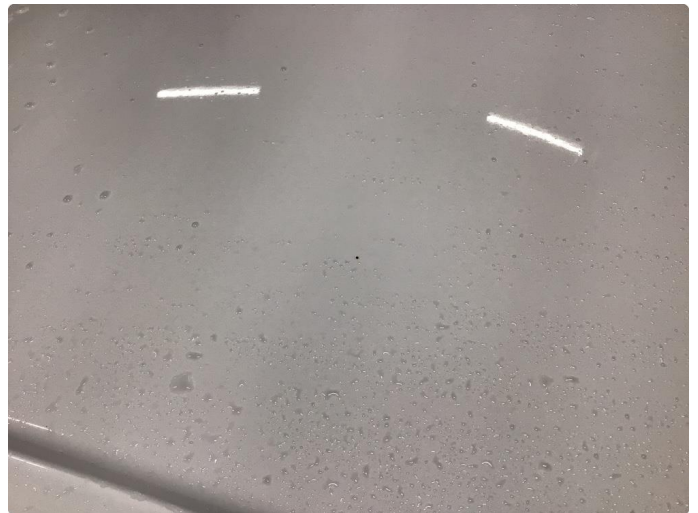
1.3 Noe steinsprut på tak
