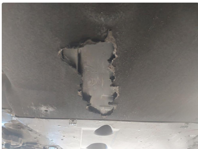
2.1 Besyttelsesplate skadet, skrapemerke på batteripakke. Ikke kritisk
