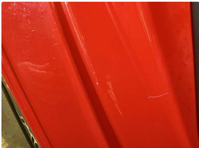
1.1 Generelt mye bruksslitasje
