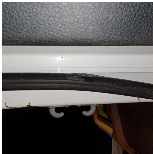
1.2 Løse/skadede lister. VURDERES VED SALG.
