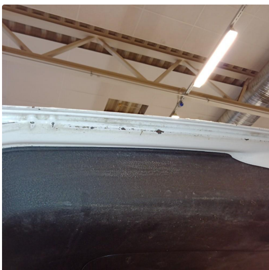
1.3 Rust/korrosjon. "OVERFLATERUST", BØR GJØRES NOE MED I FREMTIDEN.
