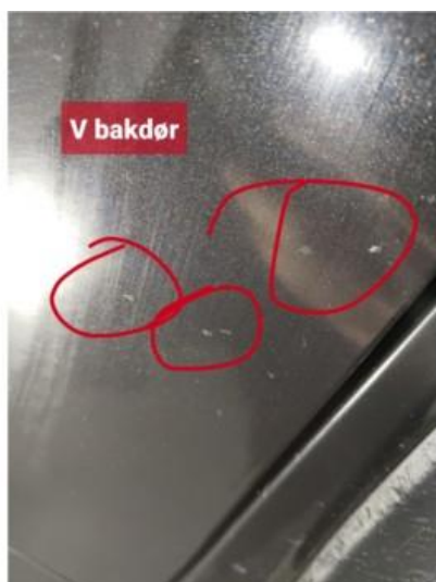
1.2 Noen dører har steinsprut med rust
