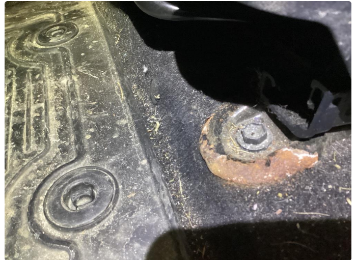
2.1 Rust i seteinnfestning innvendig
