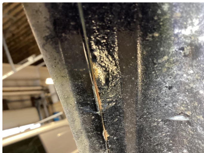
2.1 Rust i fals
