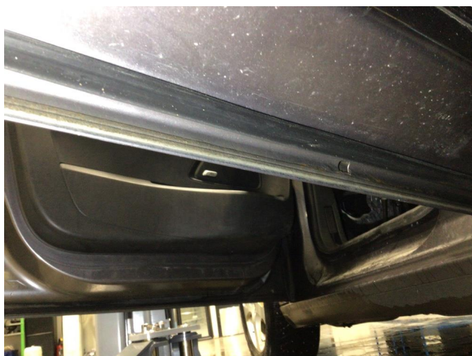
1.3 Noe korrosjon i fals på dører
