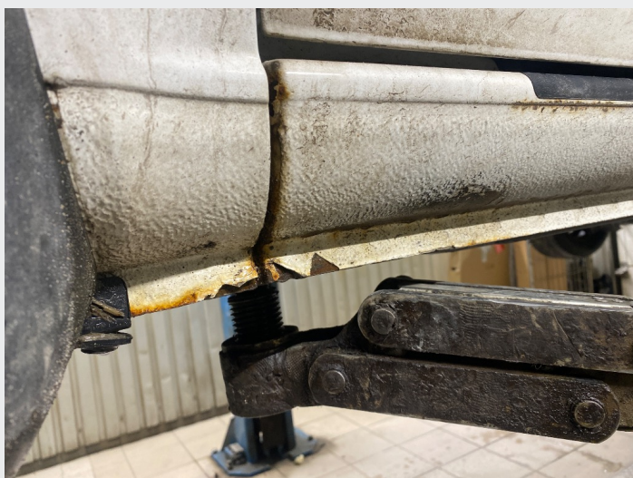
2.4 Set finnes rust på kanaler
