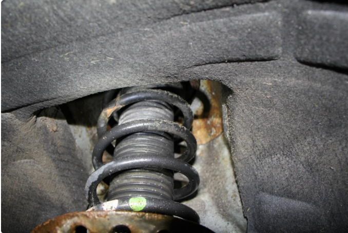
2.2 En hel del rust i chassis, også en del i hjulhus foran.
