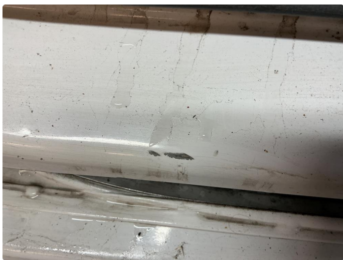
1.4 Noen riper og småbulker
