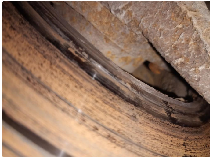
2.1 Mer enn 25% rust, blir byttet 14/1
