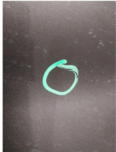
1.1 Steinsprut med rust
