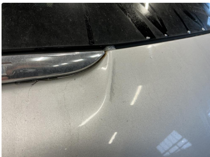
1.3 Rust. Skyldes gnisseskade fra emblem
