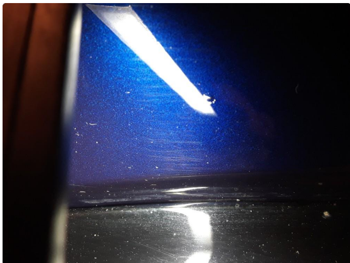
1.2 Liten steinsprut med korrosjon.
