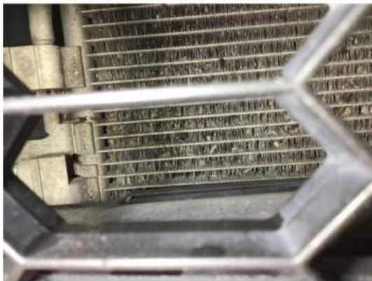
2.3 Mangler noe kjøleribber på AC kondenser
