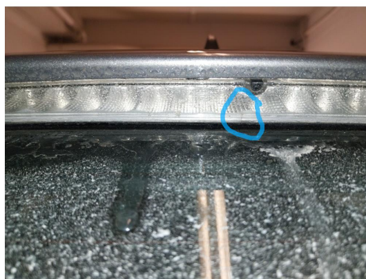
3.1 Defekt / sprukket glass
