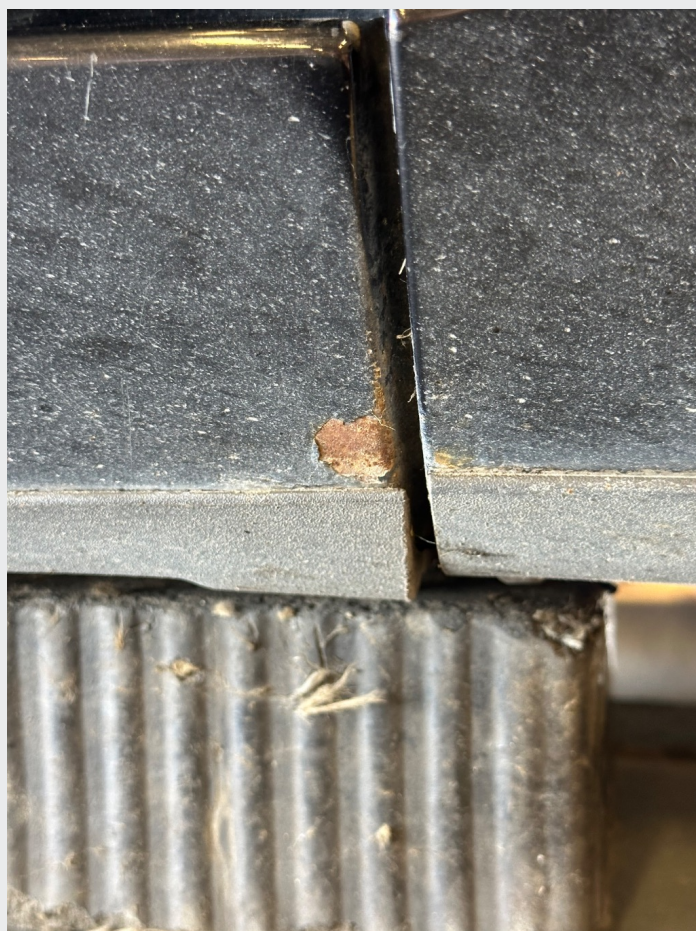
2.4 Rust kanaler bs
