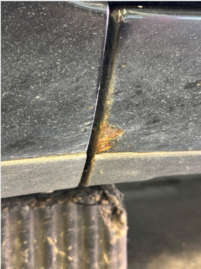
2.4 Rust kanaler bs
