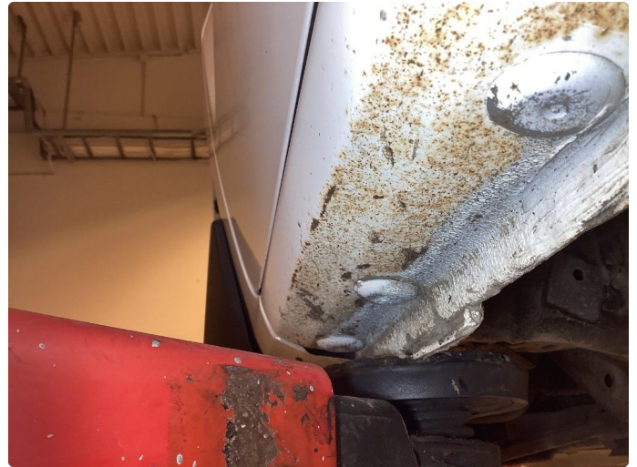
1.2 Påbegynnende overflaterust kanaler bs
