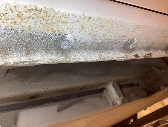
1.2 Påbegynnende overflaterust kanaler bs
